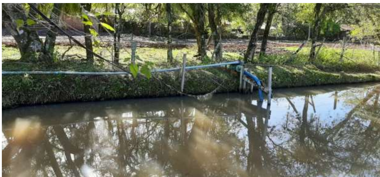
Figura 11. Sistema de bombeamento para irrigação.
