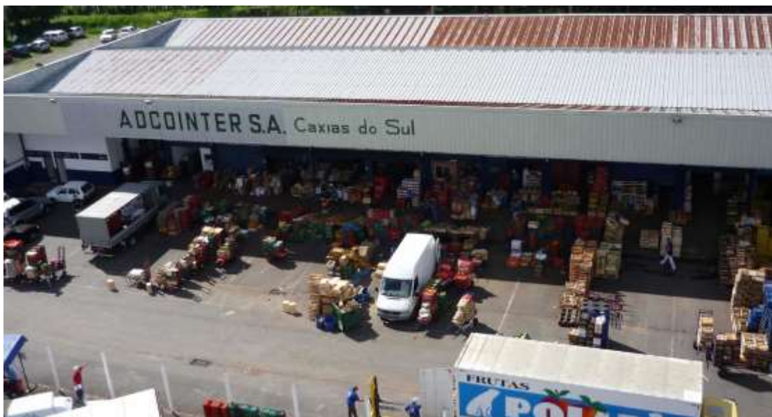
FIGURA 2 – VISTA DA FRENTE DO PAVILHÃO PERMANENTE (ATACADISTAS), LOCAL DA OBRA DAS COBERTURAS.
